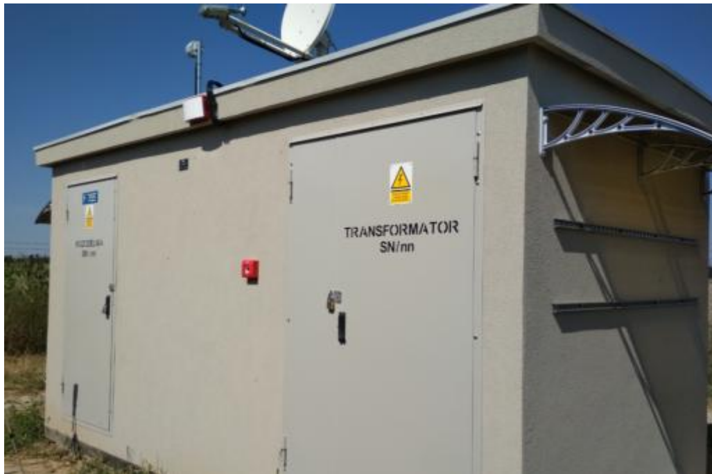
Fot. 3. Przykładowa stacja elektroenergetyczna z urządzeniami sterującymi i monitorującymi, towarzysząca instalacji fotowoltaicznej w miejscowości Olszanka (woj. opolskie) [fot. Paweł Kręciproch]
